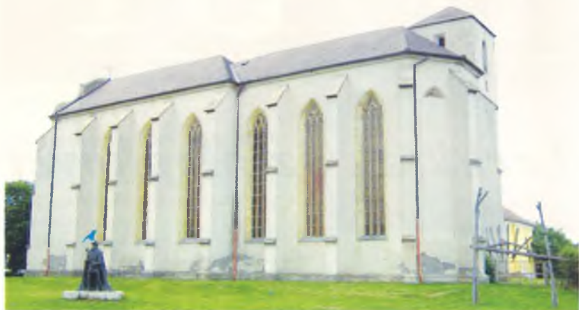
A minorita templom épületében a tetőszerkezetet is cserélni kell
